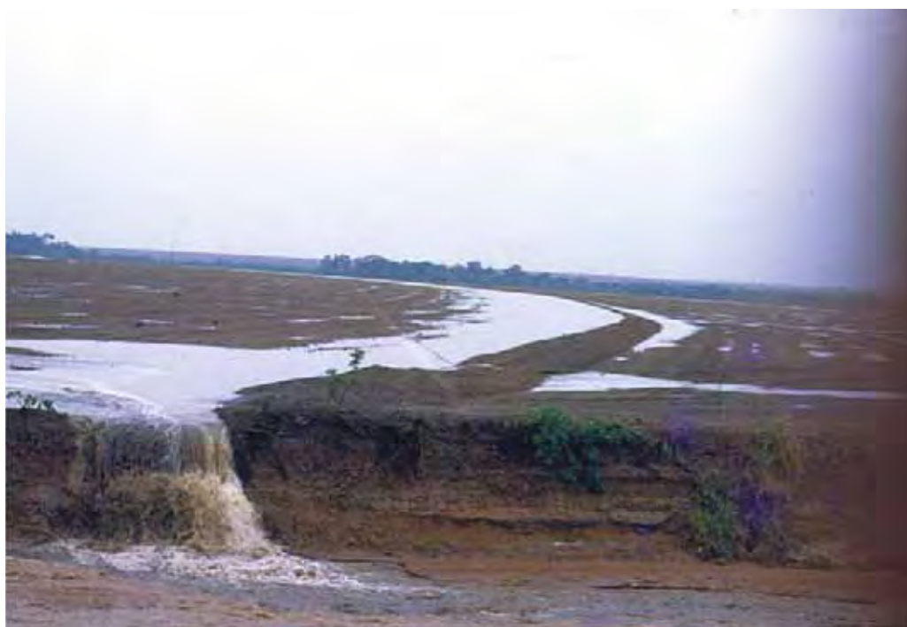
Forte érosion hydrique sur sols compactés – Cerrados Campo Verde /MT- 1995
